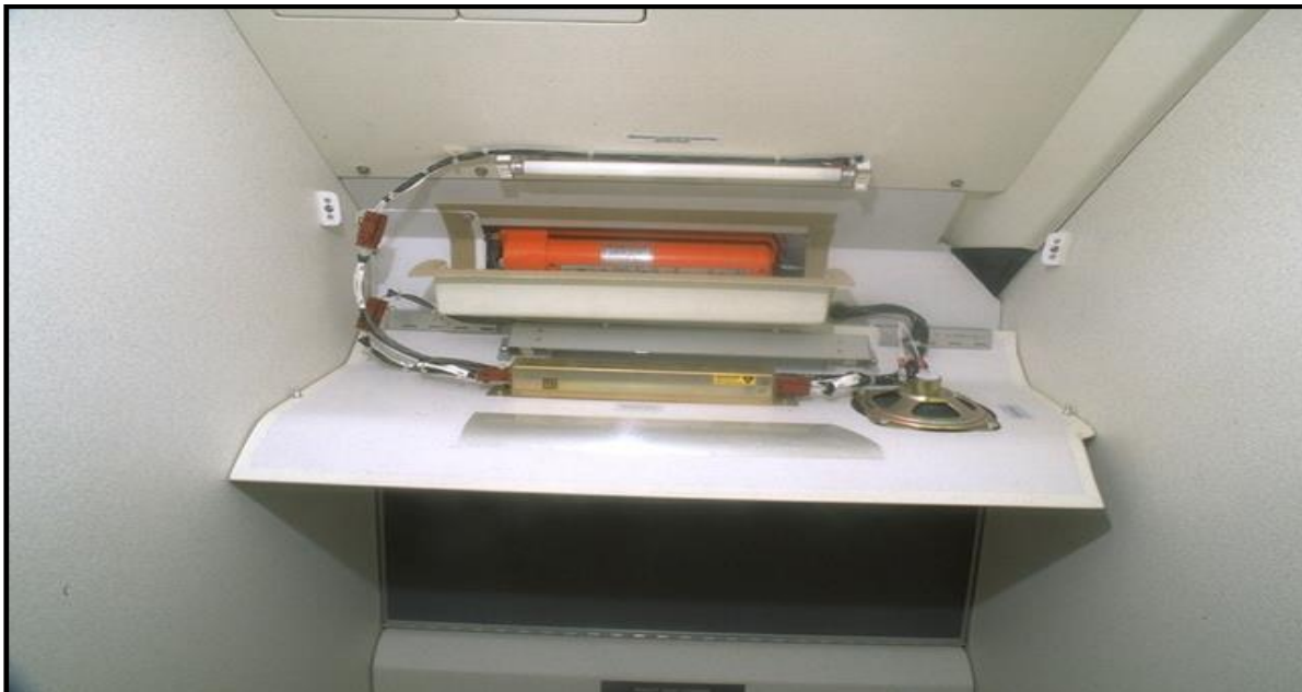
Ilustración del ELT con la puerta de compartimiento abierta en baño trasero
